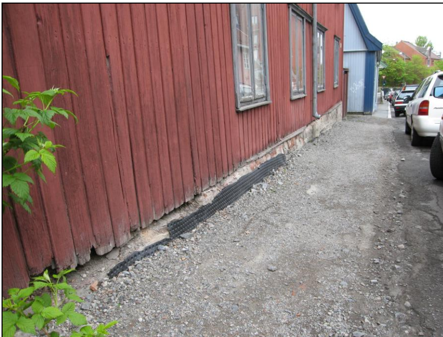
Figur 43: Råte i treverk. Mer nedbør og høyere temperatur vil gi mer råte i treverk og øket sårbarhet eller økede tilpasningskostnader knyttet til vedlikehold. Bildene viser a) Røros kirke, og b) Råte i treverk i eldre bygning i Maridalsveien i Oslo (Kilder: a. http://www.nrk.no , b Foto: Terje Grøntoft, 2007).
