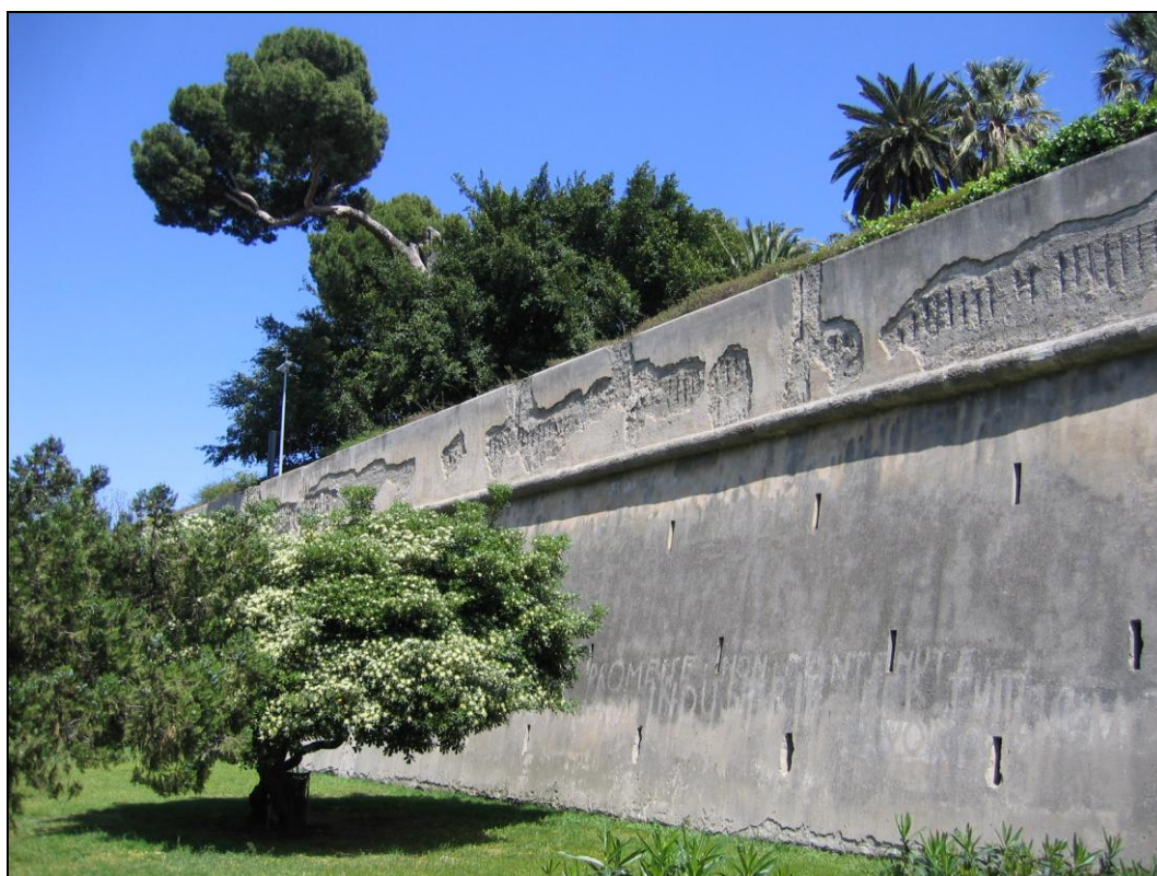
Figur 22: En sammensatt bygningsstruktur kan brytes ned p.g.a. ulike egenskaper til materialene den er laget av. Fysisk skade på betong p.g.a. korrosjon og påfølgende utvidelse av armeringsjern. Bildet viser forstøtningsmur rundt park bak "Palazzo dei Normanni" i Palermo, Italia. (Foto: Terje Grøntoft, 2006).
