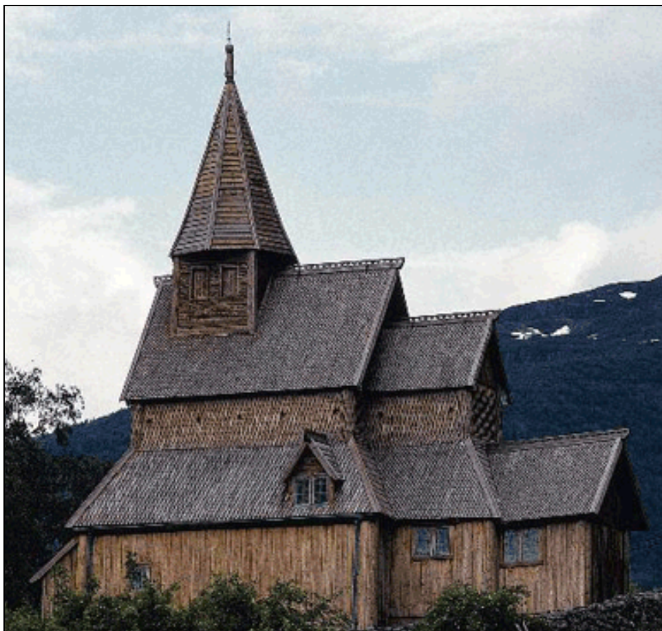
Figur 40: Hvor sårbare er våre kulturminner? I løpet av år 2008 startes restaurering av Urnes stavkirke for å gi den et stabilt fundament. Tele om vinteren fører til bevegelse, slitasje og dårlig oppstøtting av grunnstokkene. Klimaendringer vil sannsynligvis føre til endringer i bl.a. utbredelse og varighet for tele i grunnen. Hvordan vil klimaendringer påvirke kostnader til vedlikehold og restaurering og tilpasning som reduserer skadeomfang og skadekostnader for kulturminner? (Kilde: http://www.bt.no , foto: Lillebø, J.M.).
