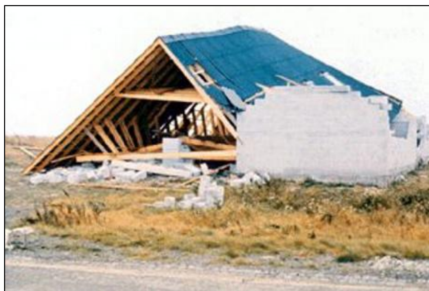
Figur 8: Sterk vind kan føre til store mekaniske skader på bygninger og bygningskonstruksjoner slik som gavler og tak. Bildene a) og b) viser skader etter storm i Danmark i 1999. (Kilde: www.husetoghaven.dk ).
