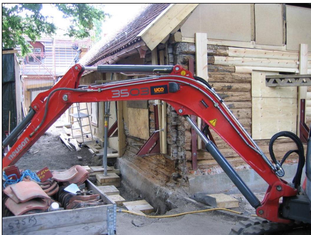
Figur 35: Klimaendringer er forventet å gi mer råte i og større renoveringskostnader for trebygninger. Bildet viser utbedring av råteskader på Tøyen Hovedgård, Oslo, sommeren 2006. (Foto: Terje Grøntoft).
