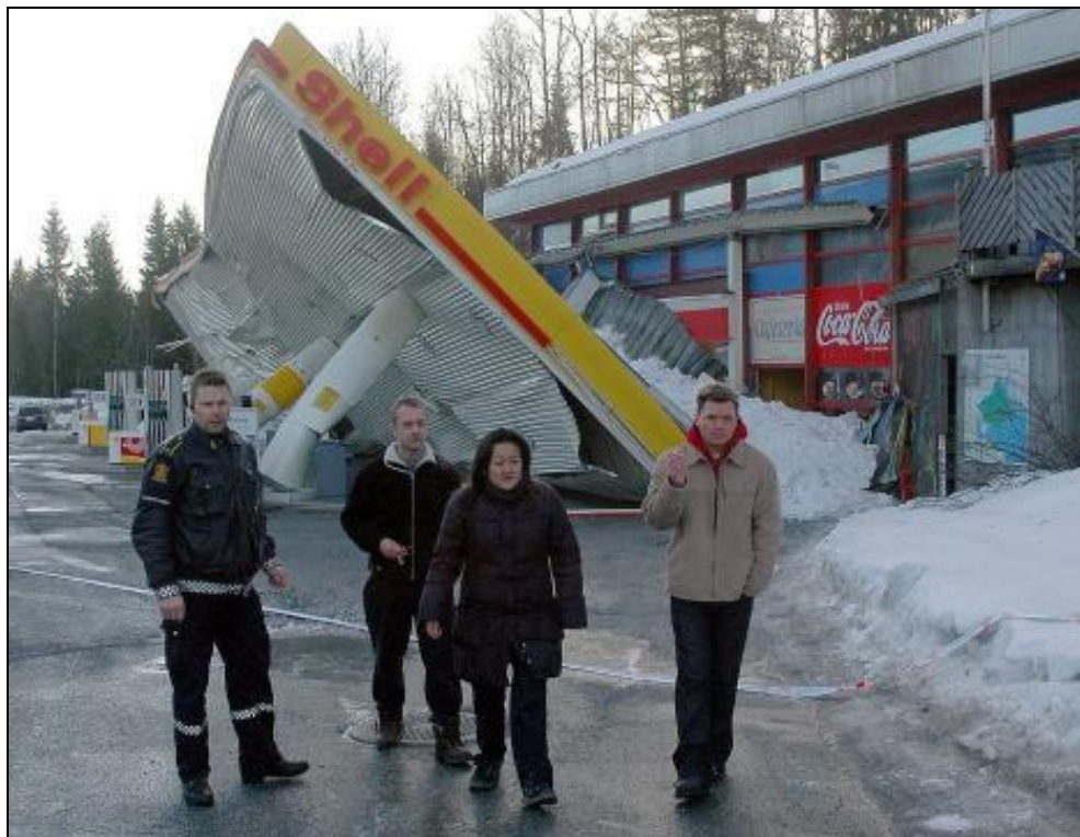
Figur 14: Stor snølast utgjør en betydelig risiko for sammenbrudd i bygningskonstruksjoner. Bildet viser sammenrast takkonstruksjon på bensinstasjon, Stokkebekken i Bamle, Telemark, 30. Mars 2008. - Vinteren 2008 raste 15 bygninger sammen i Norge p.g.a. snølast (Kilde: http://www.tu.no ).
